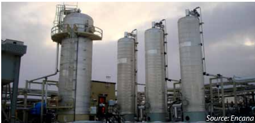
Usine de recyclage et de traitement de l'eau Debolt d'une capacité de 100 000 barils par jour exploitée par les sociétés Encana et Apache dans le bassin de la rivière Horn, en Colombie-Britannique
